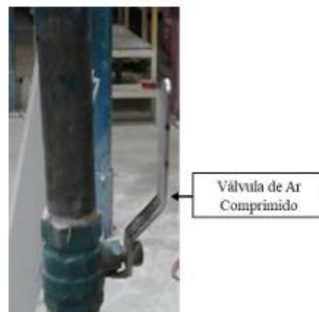
Imagem 05. Válvula de acionamento de Ar Comprimido.
